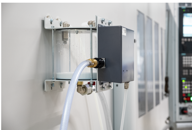
Vakuum-Erzeuger CVU an CNC-Bearbeitungszentrum bei der Metallbearbeitung
